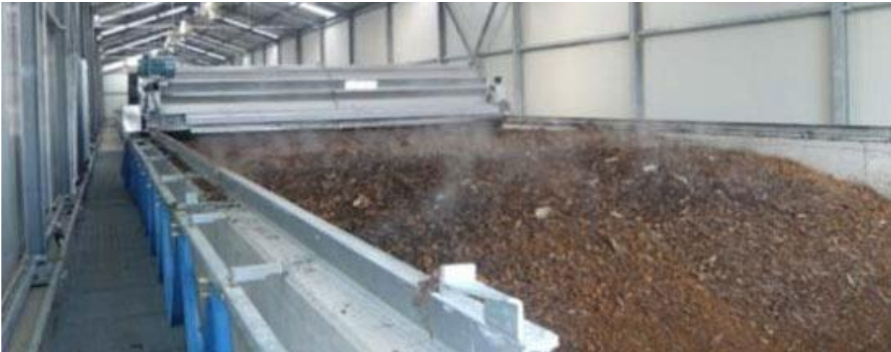
Esempio di impianto di Compostaggio Aerobico industriale
